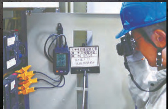
Mostrar secuencia de fases, voltaje trifásico Utilice fotos de certificación de obra tal como están
